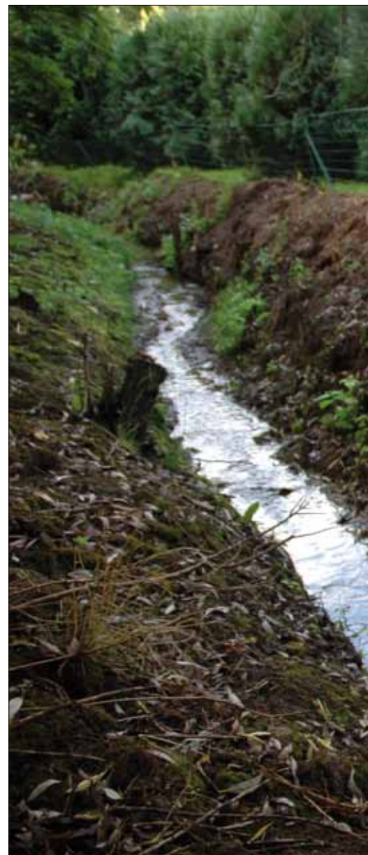
La dégradation des berges d'
